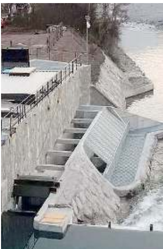
InBre. Uno degli impianti idroelettrici
